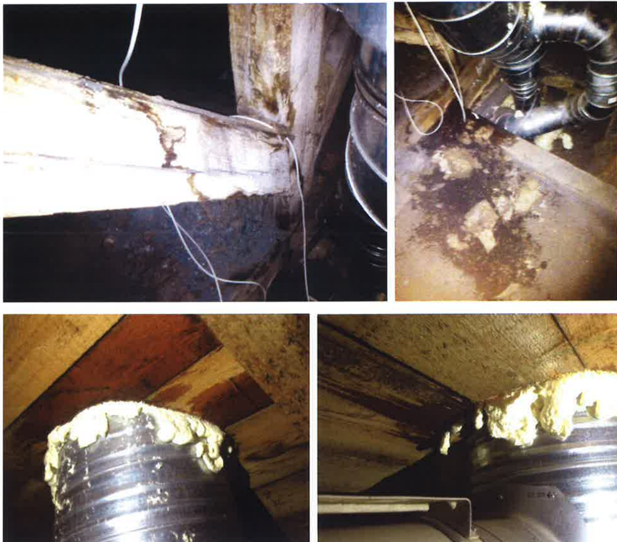
19., 20., 21., 22. attēls. Ventilācijas vadu izvadu vietas nav veidotas hermētiskas (V. Kalmikova 27.10.2017. fotofiksācijas).
