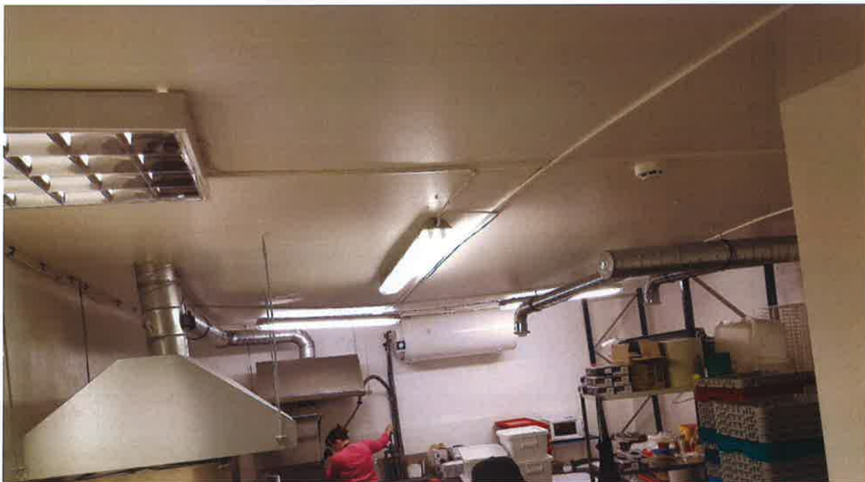
23. attēls. Ventilācijas vadi telpā Nr. 12 (foto no arhīva).
