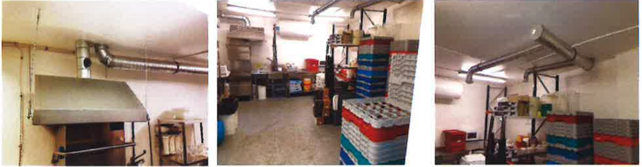
10., 11., 12. attēls. Noliktavas Rīgā, Brīvības ielā 188, k-1, lit.003 telpā Nr. 12 izvietotās mazgāšanas iekārtas (arhīva foto).
