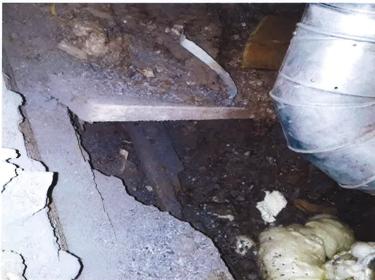
18. attēls. Noliktavas Rīgā, Brīvības ielā 188, k-1, lit.003 bēniņu pārseguma virs telpas Nr. 12 tuvplāns (TS darbinieku foto).
