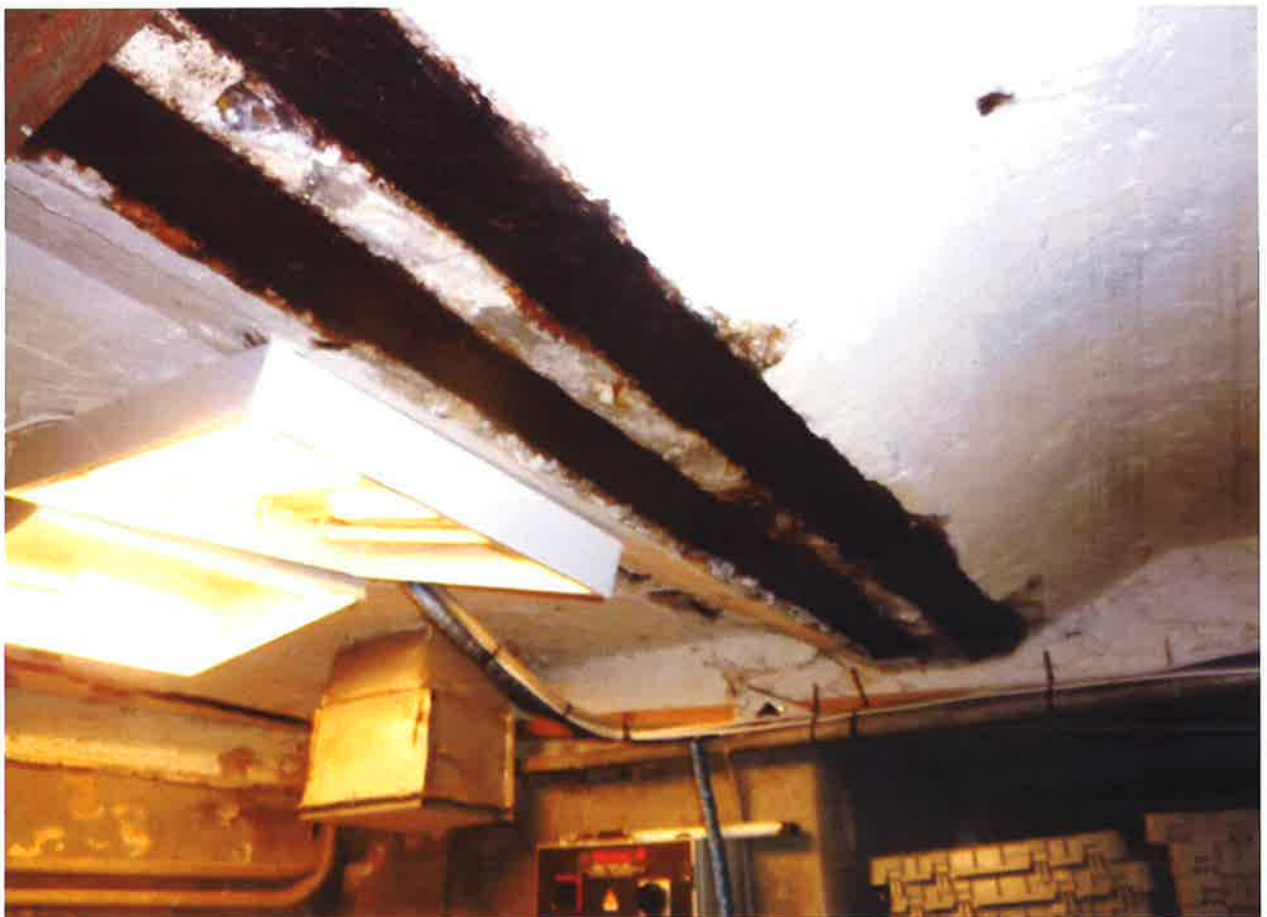
28. attēls. Nesošo siju un pasiju apakšējie plaukti mēģināti attīrīt un apstrādāt ar pretrūcēšanas materiālu.
